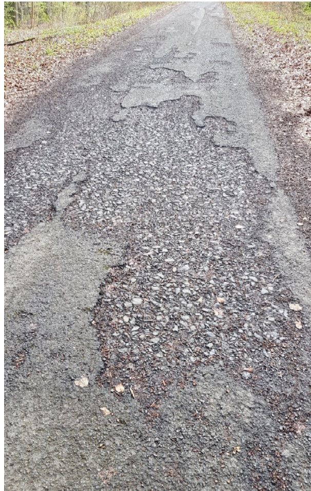
Abb. 31: Der stark frequentierte Weg östlich des Kehrs ist durch die schadhafte Asphaltdecke und Schlaglöcher für Rollstuhlfahrer nur schwer passierbar (Aufnahme vom 14.04.2023, döpel Landschaftsplanung).
